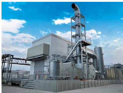
設置したガスコージェネレーションシステム外観
