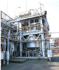
蒸留回収設備
