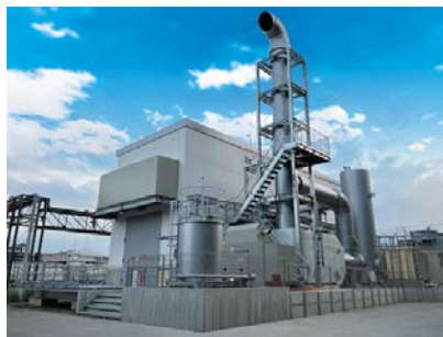
設置したガスコージェネレーションシステム外観
