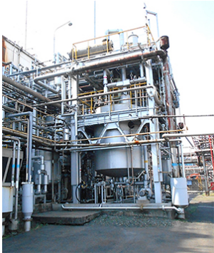
蒸留回収設備
