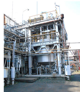
蒸留回収設備
