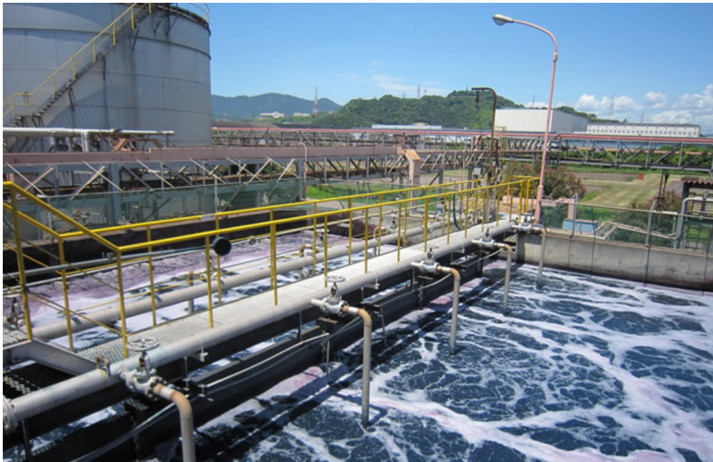
福山工場で稼働中の超微細気泡散気管
