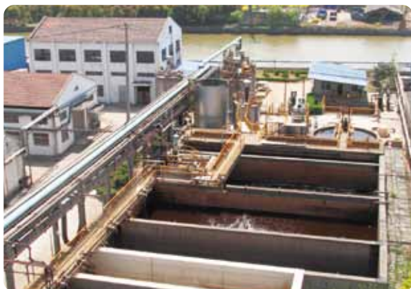
無錫先進化薬化工有限公司の廃水処理設備
