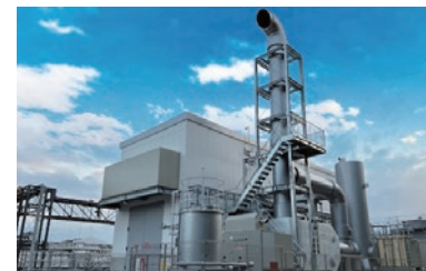
設置したガスコージェネレーションシステム外観
