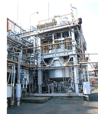
蒸留回収設備
