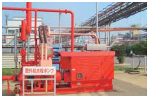
消防施設(福山工場)
