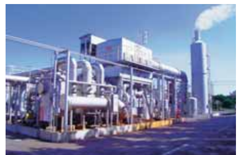
排ガス処理設備
