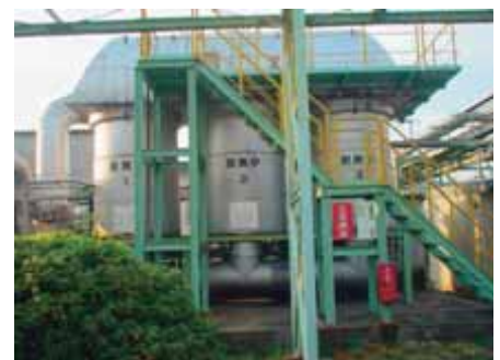
日本化薬で初めて導入した脱臭炉。800℃以上の高温で有害大気汚染物質を処理しています。
