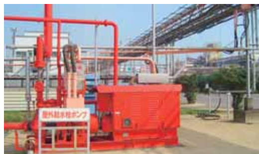
消防施設(福山工場)
