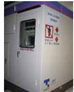
コージェネレーションシステム(2003)
