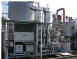
カーボン繊維を用いた吸収塔(1997)
