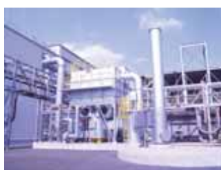
排ガス処理装置(2006)
