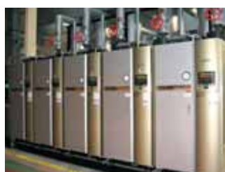
都市ガスボイラー(2005)
