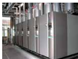
省エネルギーボイラー(2006)
