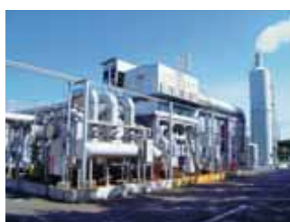
排ガス処理装置(2004)
